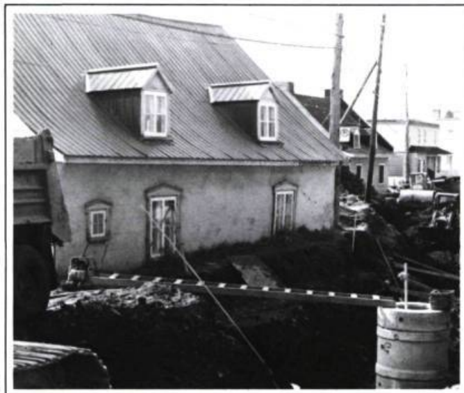
La réfection de l'avenue Royale à Château-Richer, sur la Côte-de-Beaupré. Un exemple d'intervention dans un environnement patrimonial.
