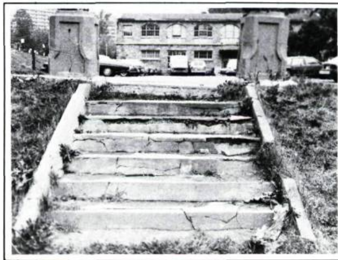
Vue détaillée de l'escalier menant au bassin: un état qui reflète la détérioration généralisée du Jardin.
