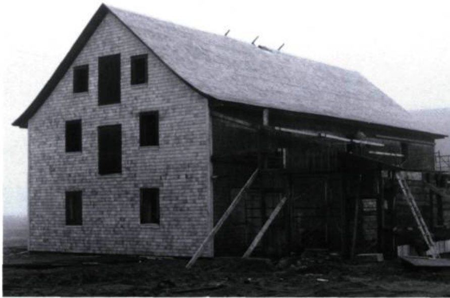
Dans les rénovations récentes des bâtiments, on a opté pour des interventions minimales. Ainsi, un grand nombre de composantes architecturales d'origine ont pu être conservées. (photo: Émile Gilbert, architecte)
