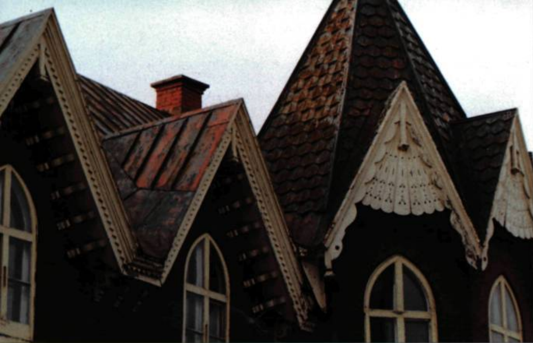
Une toiture aux nombreux « accidents » de volume : un avant-corps surmonté d'un toit conique hexagonal recouvert d'une tôle à motif imitant la tuile et percé de petits frontons en pignon revêtus d'une tôle à baguettes et un toit à deux versants recouvert d'une tôle à baguettes. Photos : François Varin
