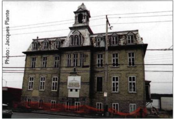
Les travaux de restauration ont peu modifié l'enveloppe extérieure du Vieux-Couvent. Toutefois, la maçonnerie, la tôle et les boiseries ont exigé d'importantes réparations.
