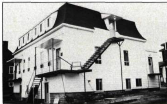
1. Vues avant et après les travaux exécutés sur un édifice remarquable du XIX e siècle, sans égard à sa qualité d'ensemble et à son détail architectural. (photo: R. Bilodeau)
