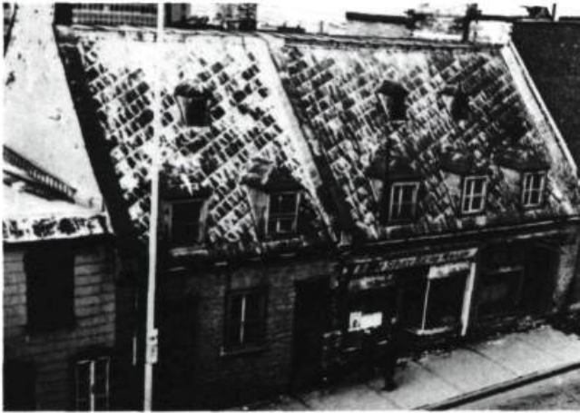
Côte d'Abraham 550 - 564 - 570. Placardée et délabrée
