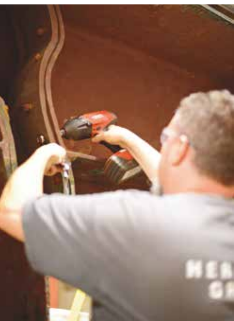
Ce restaurateur remplace les boulons de fer par d'autres en acier inoxydable.
