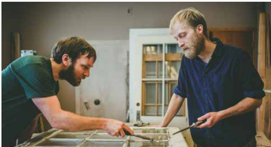
L'entretien de la maison Henry-Stuart nécessite des travaux réguliers. Ici à l'œuvre, les artisans-ébénistes qui ont restauré les fenêtres et les volets du rez-de-chaussée en 2017.
