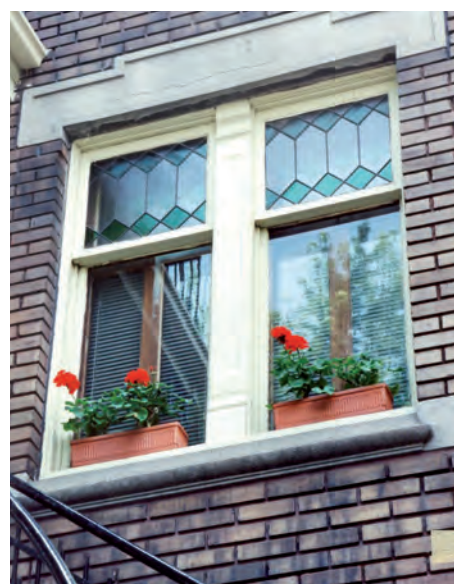
Exemple d'une fenêtre à guillotine dont le châssis supérieur est orné d'un vitrail.
