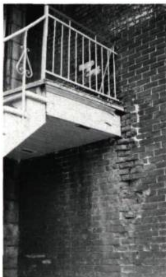
L'égouttement de l'eau sur le mur est la cause des joints évidés et des briques effritées.
