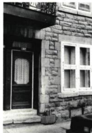
Pentes et fissures dans les éléments de maçonnerie indiquent un affaissement des fondations.
