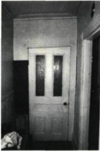
Des pentes dans les cadrages sont un signe de l'affaissement des murs porteurs.
