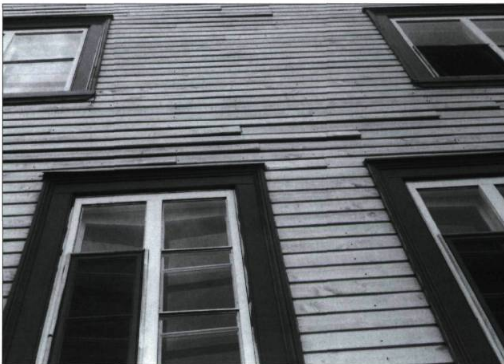
Exemple d'un clin de bois posé alors que le bois était encore humide. Le clin rétrécit en séchant, ce qui occasionne des décollements et des déformations.
