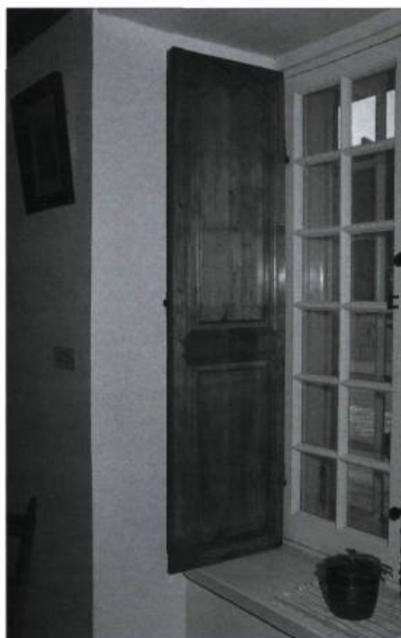
Les fenêtres à battants possédaient souvent des volets intérieurs. Ceux-ci sont ornés de caissons à panneaux soulevés et chantournés pour celui du haut. Photo: François Varin
