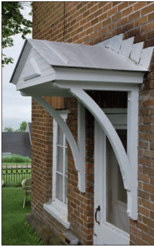
Un revêtement de toiture et des solins bien entretenus assureront une bonne durée de vie à la marquise.
