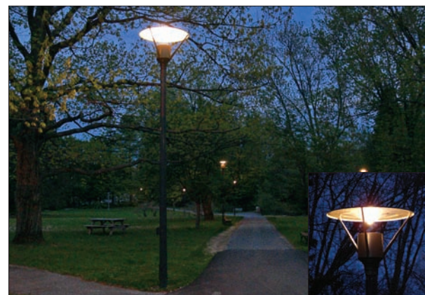
L'éclairage des sentiers du parc des Moulins, à Charlesbourg, est réussi grâce aux sources lumineuses de type indirect.
