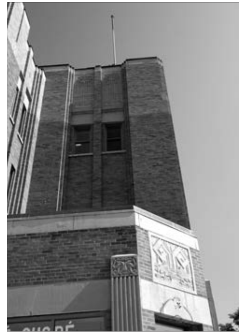
L'extérieur du Marché Saint-Jacques a été bien conservé, notamment ses bas-reliefs, mais les briques posées en haut des murs en 1997 tranchent avec les briques d'origine.
