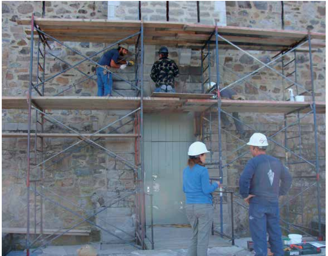
Pour leurs interventions sur de la maçonnerie ancienne, les restaurateurs font parfois appel à l'expertise de tailleurs de pierre. Photo: Mathieu Carpentier
