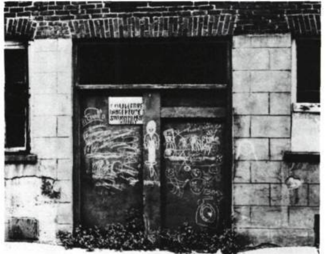
723 à 733 St-Olivier - Arrière du bâtiment et remises enfoncées
