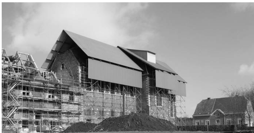
La Paix-Dieu. Une aile de l'ancienne abbaye en cours de restauration. Le Centre de perfectionnement en métiers du patrimoine sert aussi de chantier-école. Photo Claire Desmeules, février 2006.
