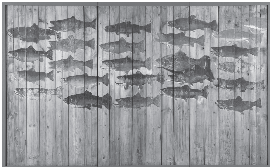
État du Mur de truites avant son traitement
