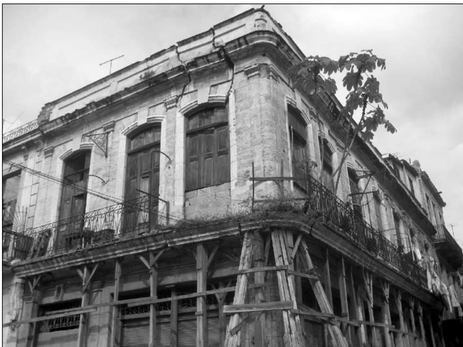
Illustration 2 : Édifice en état d'effondrement, Vieille-Havane, Cuba.
