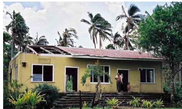
Figure 1. Une maison à Upolu, aux Îles Samoa, en partie détruite par le cyclone Heta en janvier 2004. (Kelman, 2004).
