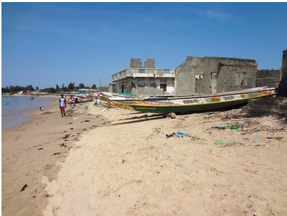
Figure 5. Érosion de la plage contribuant à la réduction de l'espace pour les pirogues et à la dégradation des maisons à Mbour.
