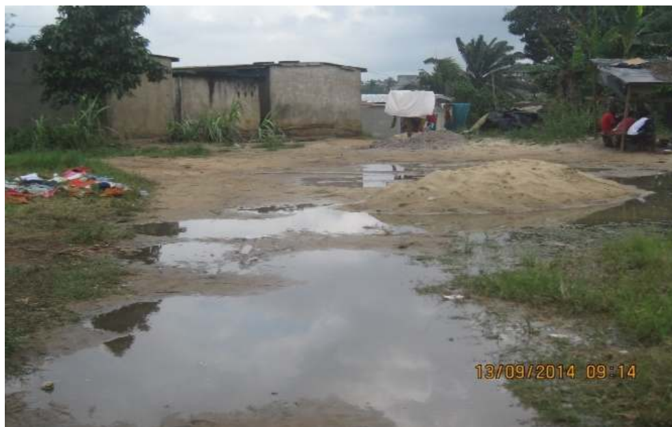
Figure 4. Déversement des eaux usées dans les rues, caniveaux, ravins et arrières-cours, Anyama Septembre 2014.
