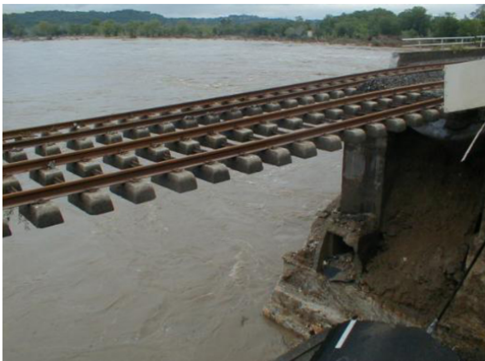
Figure 4a. Accidents régulièrement mentionnés. Effet de la crue du Gardon en 2002 sur la ligne Nîmes-Alès.
