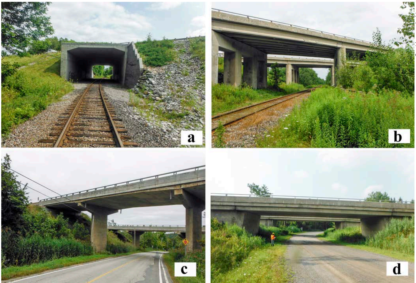
Figure 3. Ponts ferroviaires (a et b) et ponts au-dessus de routes secondaires (c et d) ayant fait l’objet d’études fauniques.
