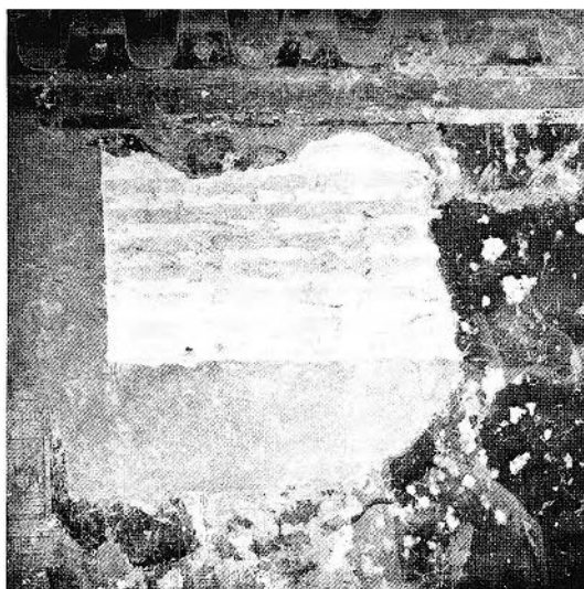
FIGURA 2. Frammento di decorazione onoriana nella parete destra del portico, venuto in luce durante la guerra e ricoperto nel corso del restauro che immediatamente seguì.
