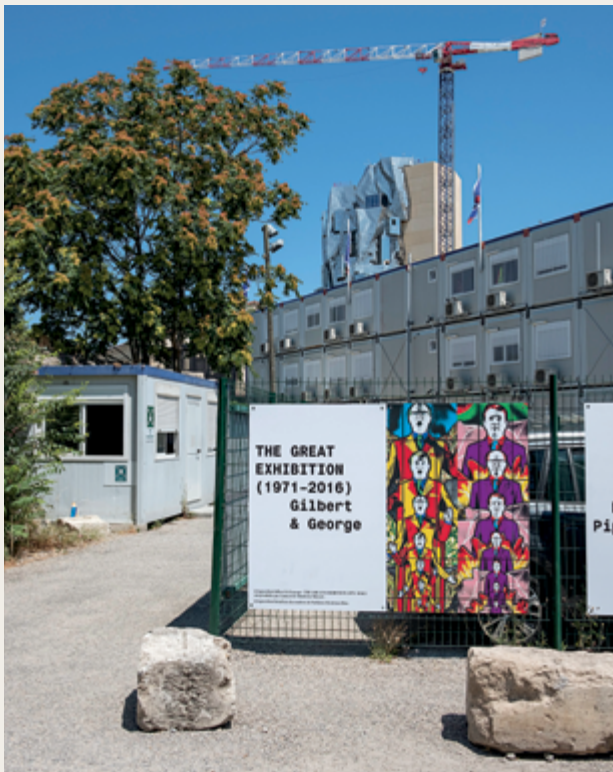
Site de la Fondation Luma, avec le nouveau bâtiment de Frank Gehry en construction / Site of Luma Foundation with Frank Gehry's building under construction photos : Bruno Chalifour
