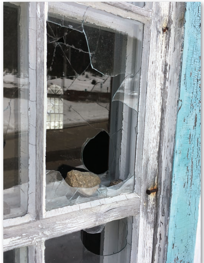
Détail d'un carreau d'une vitre fracassée par des roches. (Photo Pascal Huot, avril 2018)
