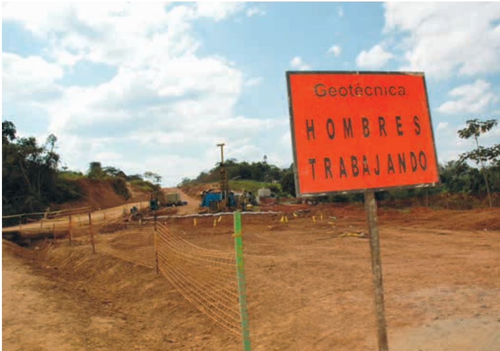
Construction de la Transamazonienne entre le Pérou et le Brésil, juin 2012. Photo : Marie-Josée Béliveau
