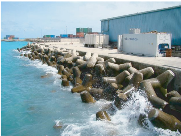
C. Cordons de tétrapodes qui protègent le port de Betio (Tarawa Sud, Kiribati) des risques liés à la mer (cliché : V. Duvat, 2010).
