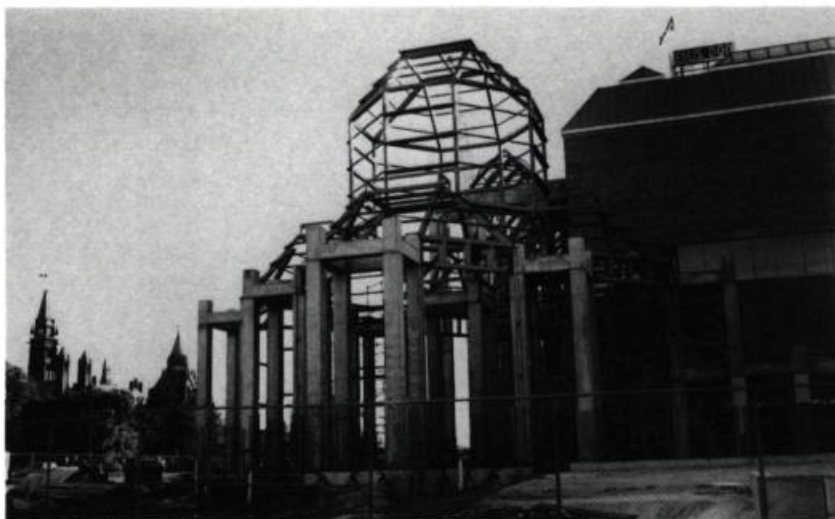
Vue du chantier du Musée des beaux-arts du Canada à Ottawa en août 1986. (photo: M. Chevalier)
