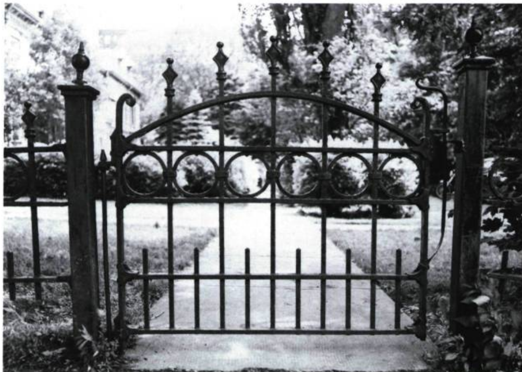
Cette clôture en fonte nécessiterait les travaux suivants: décapage, nettoyage, application d'un apprêt anti-rouille et peinture. (photo: F. Varin)
