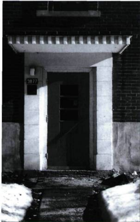
Les unités de l'ensemble Benny Farm présentent diverses innovations pour l'époque, dont l'escalier, disposé à l'intérieur.
