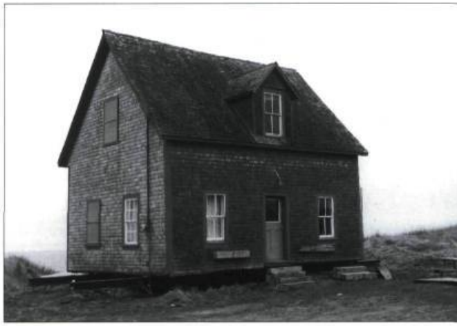
La bâtisse à charpente de bois, reposant sur des fondations de pierres sans mortier, est levée et maintenue de niveau par deux poutres d'acier glissées transversalement.
