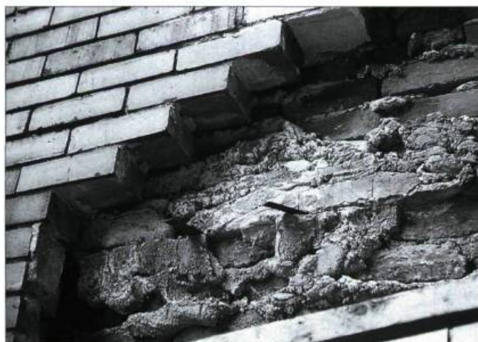
Un parement de brique « toute panneresse » dont les attaches le liant au corps de la maçonnerie ont cédé à la suite d'infiltration d'eau.
