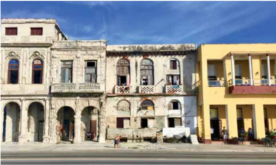
Sur le Malecón, des constructions neuves côtoient des bâtiments qui portent les stigmates de leur exposition constante à l'air salin.
