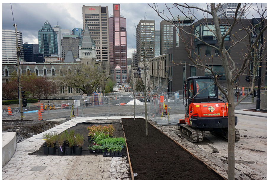
Figure 7. Étape de la promenade : les travaux dans la rue McTavish, mai 2017. (Source : H. Sturm).
