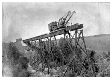
D'autres obstacles se dressent sur la route, dont plusieurs rivières. En tout, on devra construire pas moins de 26 ponts!
