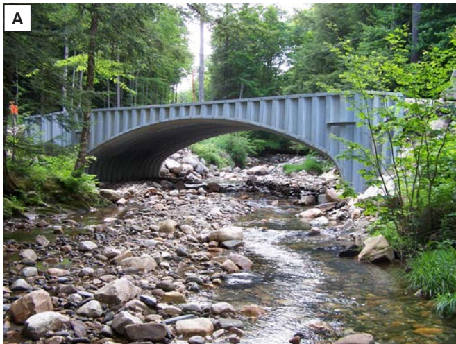
Figure 2. a) Un ponceau sur le ruisseau Bronson, au Massachusetts, qui n'a pas été conçu pour répondre aux normes optimales de franchissement des cours d'eau. Il représentait une barrière au passage des poissons et a cédé lors d'une forte pluie; b) La structure de remplacement a été conçue à l'aide de la méthode de simulation de cours d'eau: elle présente une grande ouverture par rapport à sa longueur, la largeur du passage est d'au moins 1,2 fois celle de la largeur au débit de plein bord, et le substrat correspond au lit naturel du cours d'eau. Cette structure a résisté aux inondations de la tempête tropicale Irène sans être endommagée.
